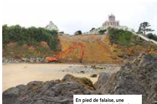
En pied de falaise, une pelleteuse équipée d'un bras spécifique achève de déblayer les secteurs potentiellement instables de la zone.
