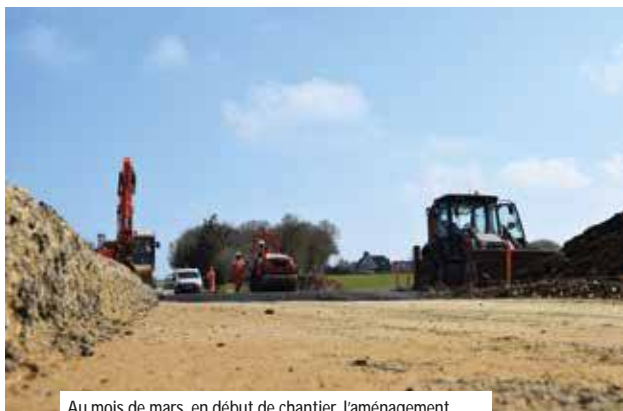
Au mois de mars, en début de chantier, l'aménagement du carrefour des Prés Mario a nécessité un décaissement de la voie avant empierrement et pose des couches successives (fondations et revêtement de surface).
